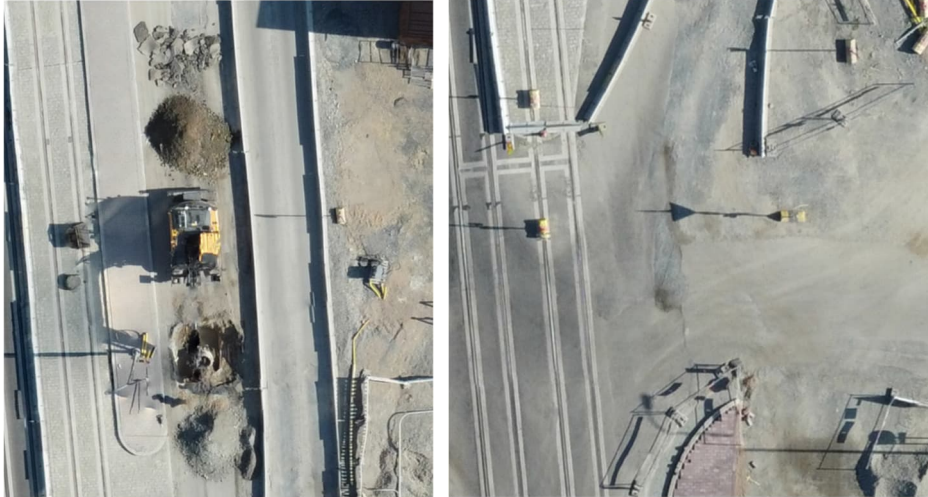
Kuva 5. Ortokuvasta voi tehdä hyvin havaintoja mm. materiaalin läjityksestä työmaa-alueella (vasen) sekä väylän reuna-aitojen sijoittelusta (vasen).
